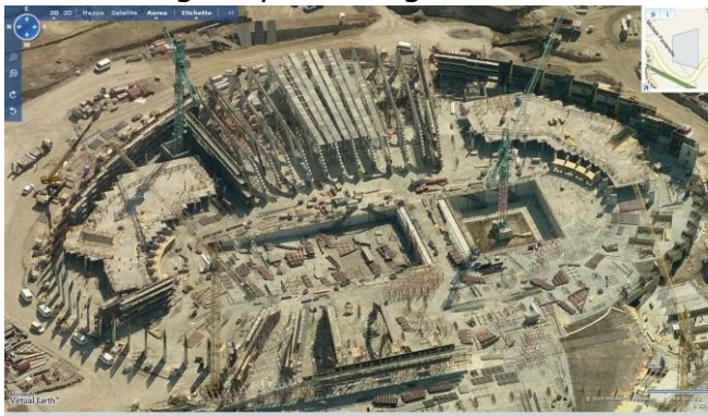
Santiago Calatrava, vista aerea del cantiere della Città dello sport a Tor Vergata, Roma.
