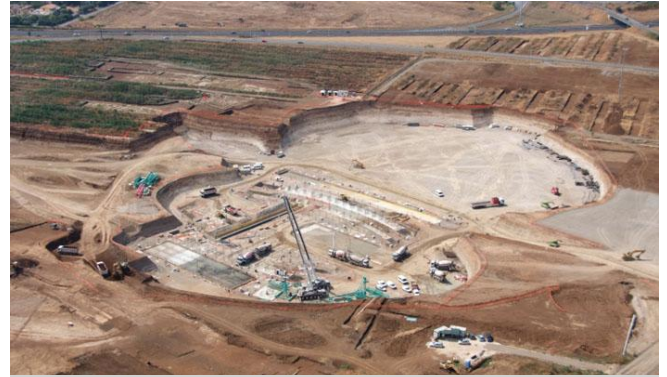
Santiago Calatrava, vista aerea dello scavo delle fondazioni della Città dello sport a Tor Vergata, Roma.
