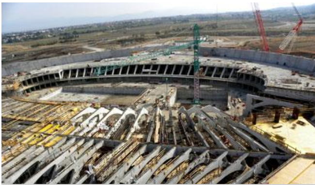
Santiago Calatrava, vista del cantiere della Città dello sport a Tor Vergata, Roma.
